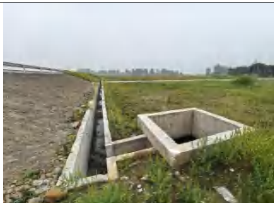
复耕地块配套设施（截排水沟+蓄水池）
