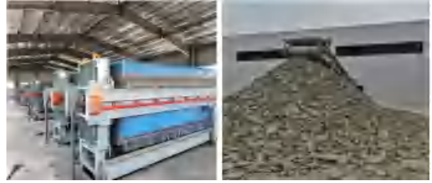
底泥处理厂脱泥固化系统
