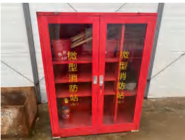
营地消防设施照片
