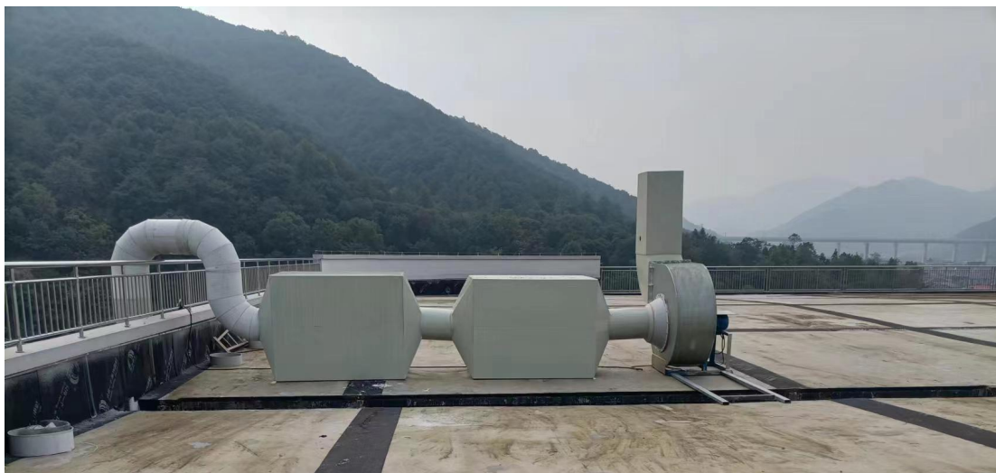
印刷油墨、上光、洗车废气处理设备
