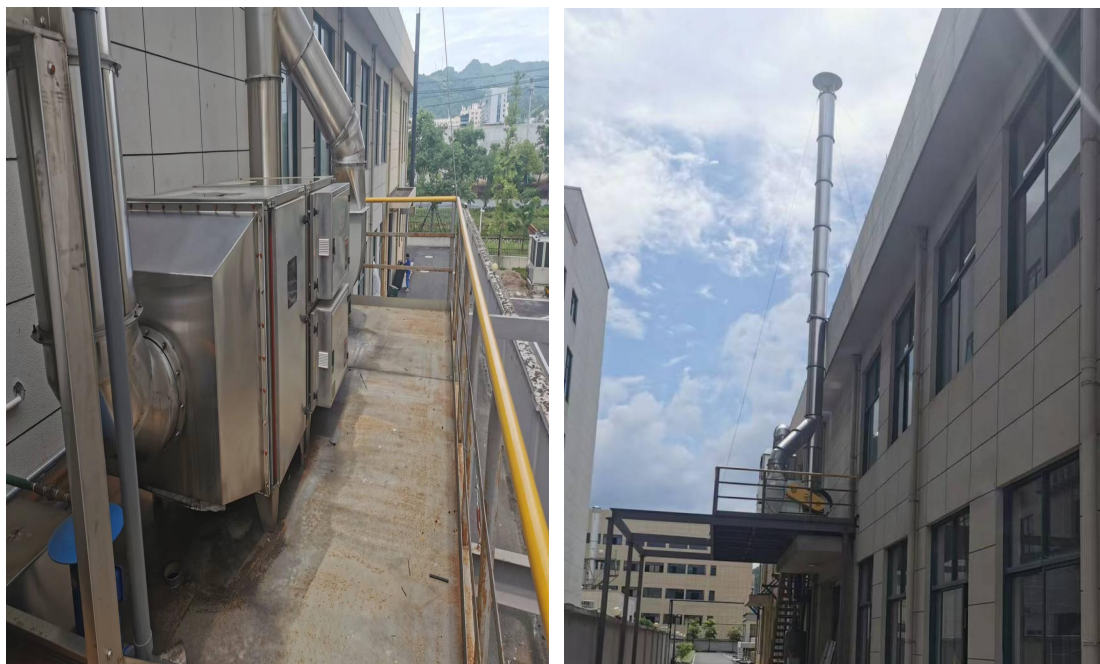
储罐呼吸废气、搅拌、冷却、灌装、均质脱气、研磨废气处理设备及排气筒
