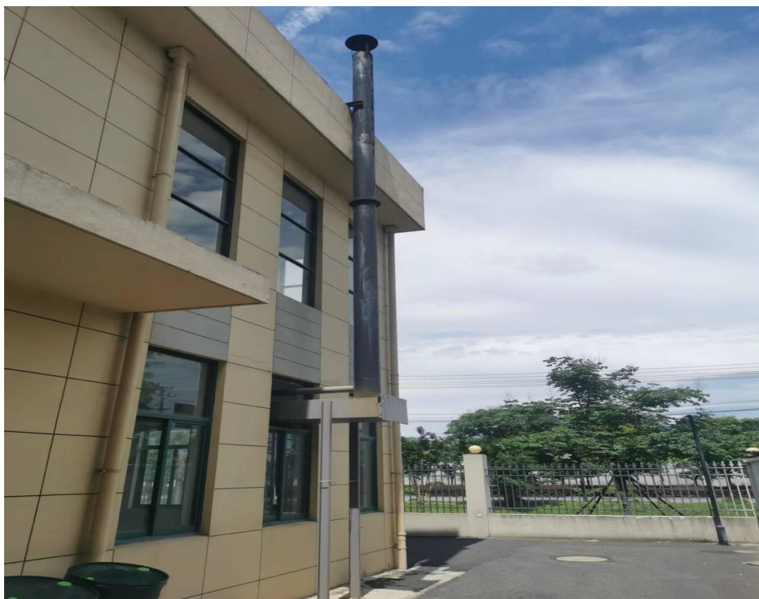
天然气锅炉燃烧废气排气筒
